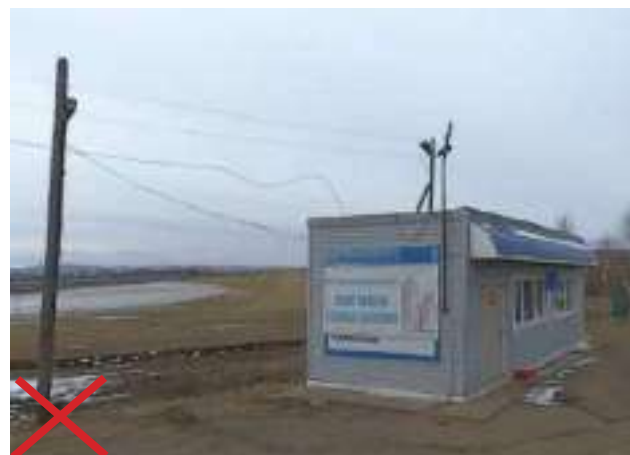
Недопустимо устраивать освещение с помощью прожектора на деревянной опоре и стойке на павильоне.
